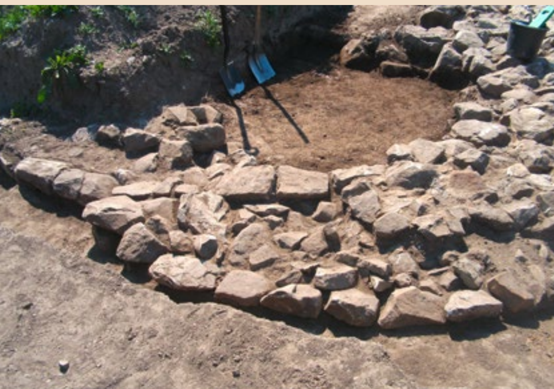
Das abgerutschte Fundament des östlichen Rundturmes
